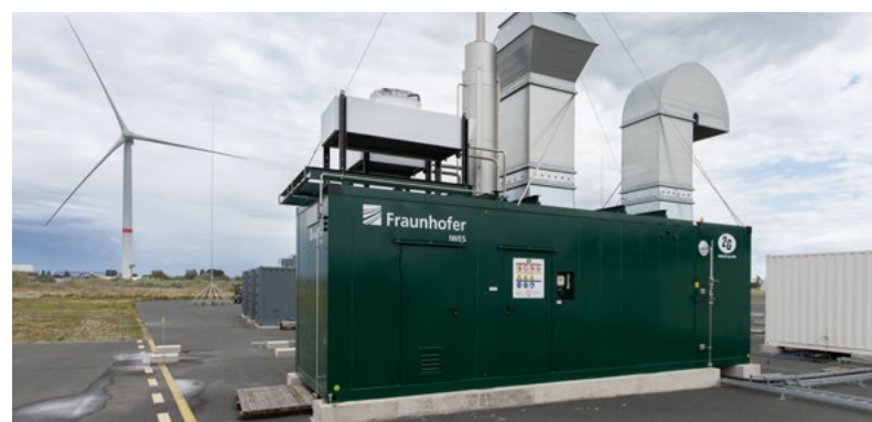
Wasserstoff-BHKW auf einer Prüffläche des HLB, im Hintergrund: die Offshore-Prototyp-Windenergieanlage AD8-180
